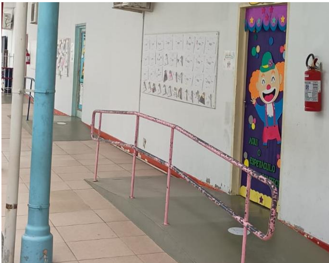
Detalhe dos extintores de incêndio acoplados a parede.
